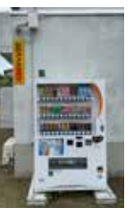
自動販売機とセットで設置された防犯カメラ（左上部）
